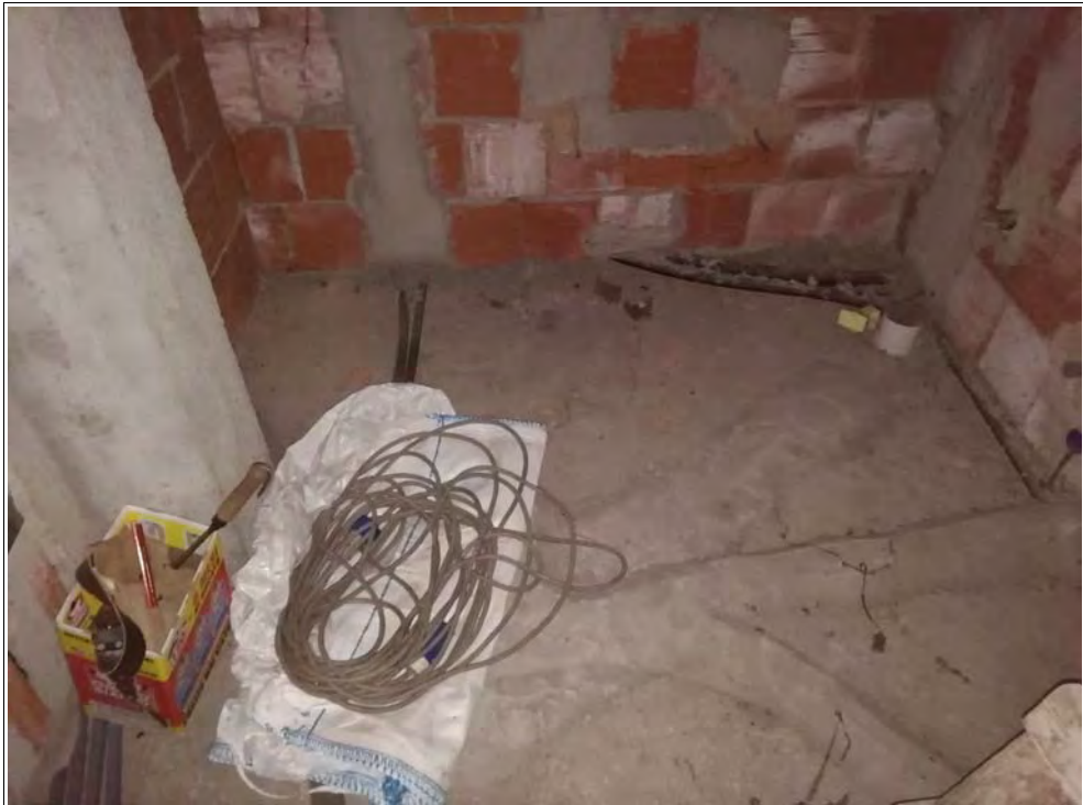
Foto 11: Particolare del locale tecnico
