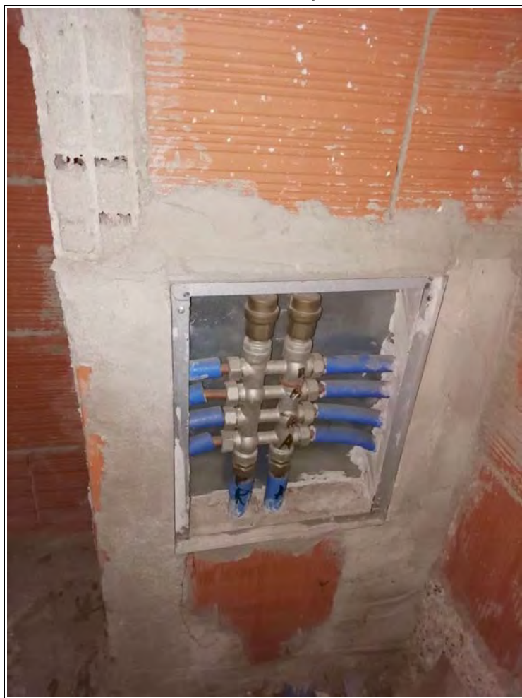
Foto 11: Particolare dell'impianto idrotermosanitario
