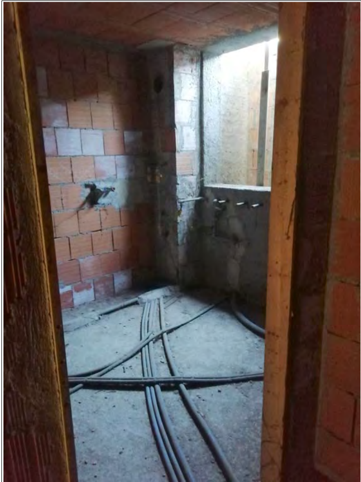
Foto 7: Particolare del locale tecnico
