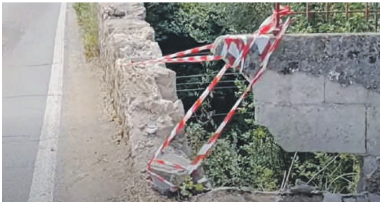
Il tratto pericoloso del ponte in via delle Mimose
