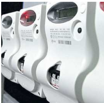
Alcuni contatori elettrici
