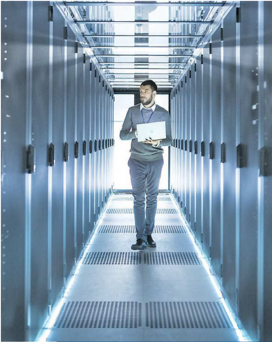
Dallo sviluppo dei data center dipende la rapidità della crescita e del miglioramento dei sistemi di intelligenza artificiale nel mondo
