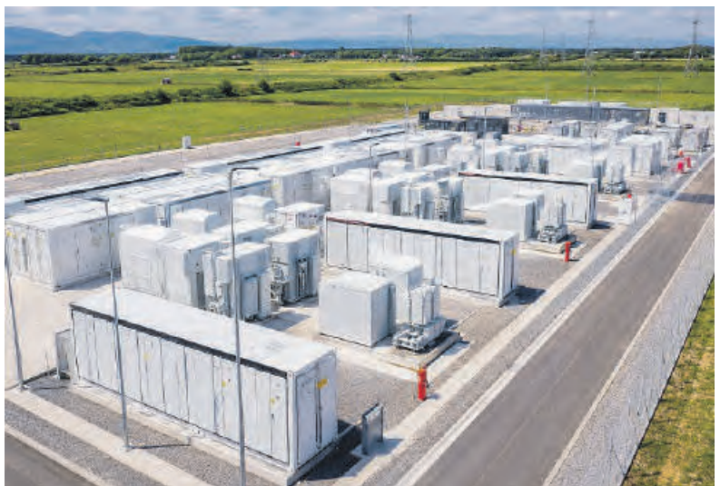
Un impianto di Bess
