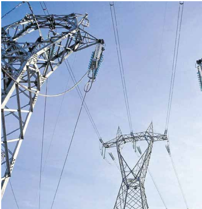
Tralici della rete di trasmissione elettrica
