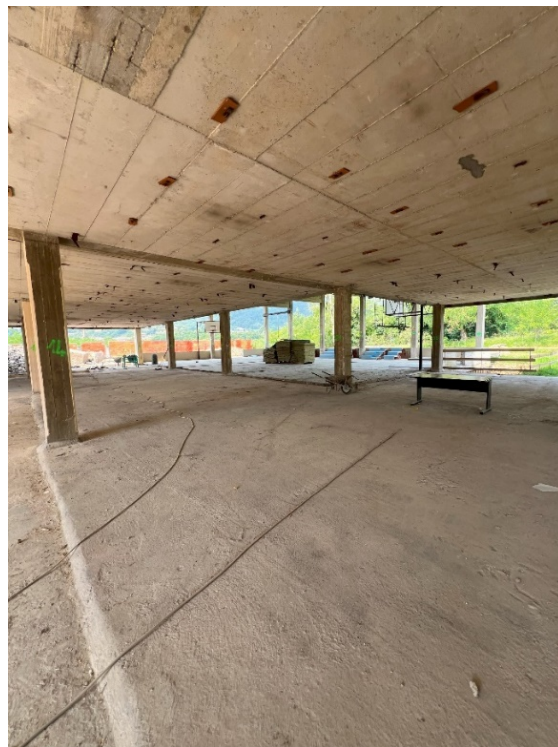
Figura 7 - Pavimentazione e massetti demoliti
