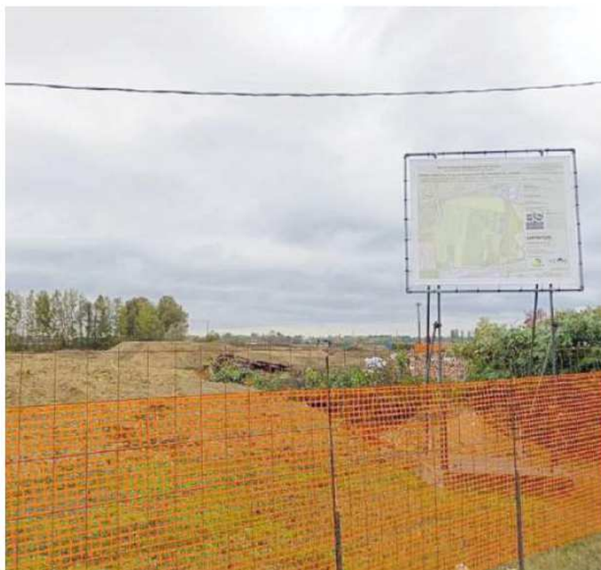
L'area in cui è stato avviato il cantiere per la realizzazione delle maxi vasche di laminazione
