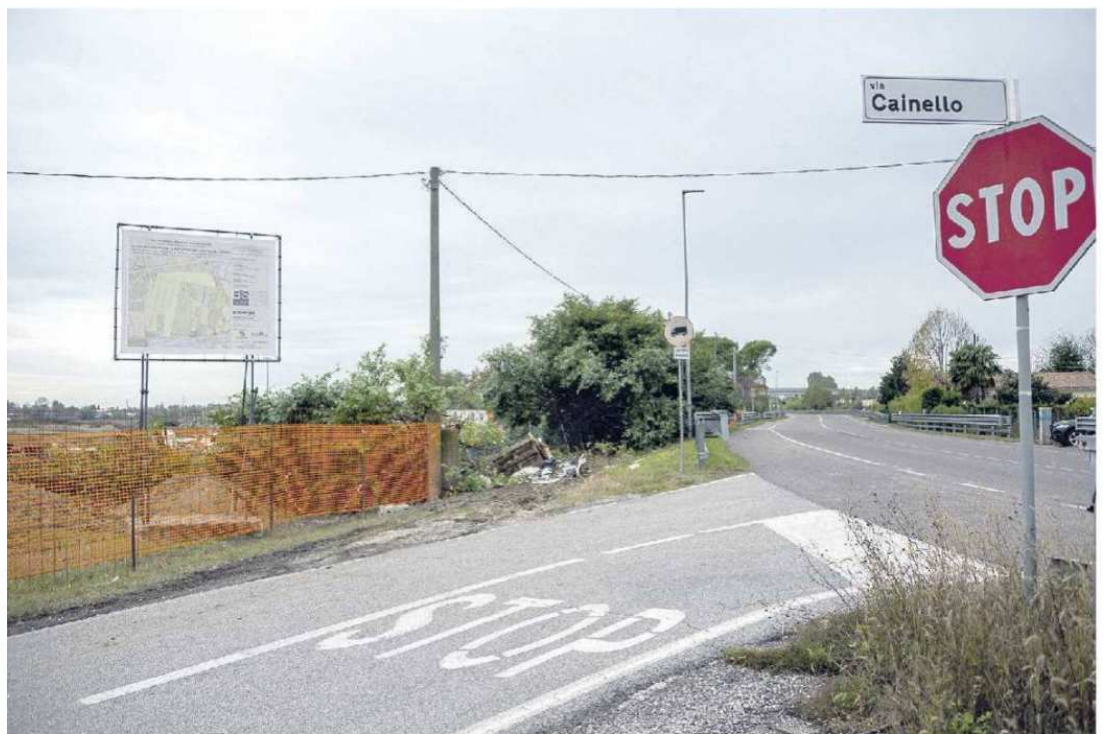
LAVORI IN CORSO Aperto il cantiere sull'area dell'ex Veneto City (nel riquadro il vecchio progetto) dove nascerà il nuovo polo logistico
