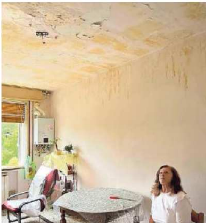
Una casa con infiltrazioni al tetto non ancora riparato
