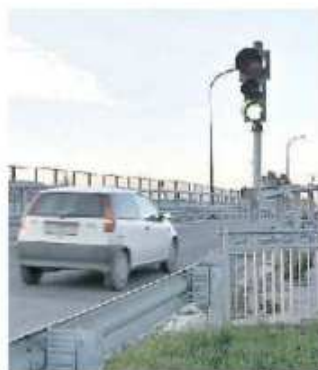
DA RICOSTRUIRE Il cavalcavia di via Bottenigo
