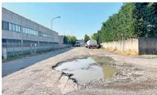
La situazione di degrado delle strade nella zona industriale
