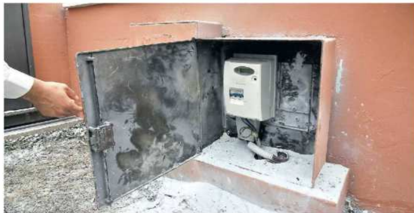
SURRISCALDAMENTO Molti quadri e contatori elettrici a causa del caldo si surriscaldano mandando in tilt l'intera linea
