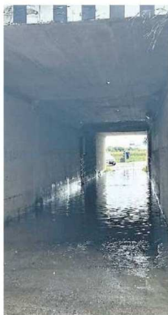
MIRANO Sottopassi allagati e mezzo metro d'acqua in casa
