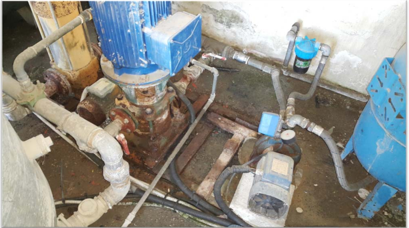
Figura 26: Pozzo del Campo Sportivo di via Giovanni Falcone
