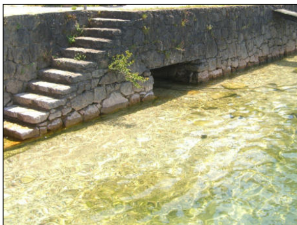
Foto 6 ambito Valle Buraga - particolare della condotta in cemento che «sfocia» nel Lago
