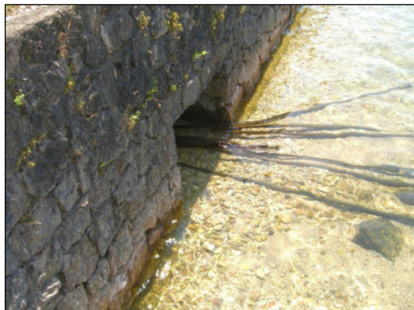
Foto 4 ambito Valle Rossone - particolare della condotta in cemento che «sfocia» nel Lago
