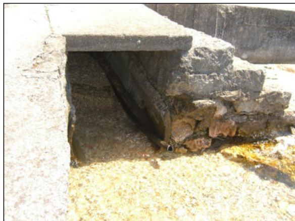
Foto 4 ambito Valle La Mercantina - particolare della condotta in cemento che «sfocia» nel Lago
