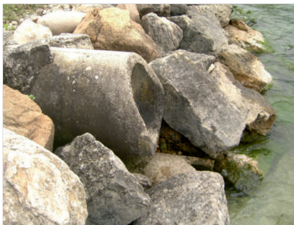
Foto ambito Valle dei Canevini - particolare della condotta in cemento che «sfocia» nel Lago
