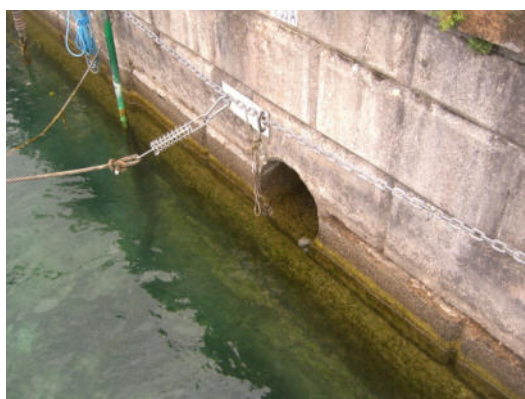
Foto 7 ambito Valle Santa Croce - particolare della condotta in cemento che «sfocia» nel Lago
