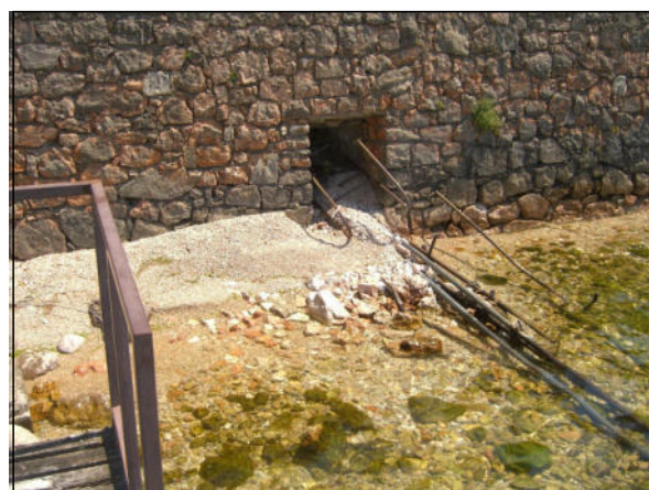
Foto 4 ambito Valle di Castel Ronco SUD - particolare della condotta in cemento che «sfocia» nel Lago
