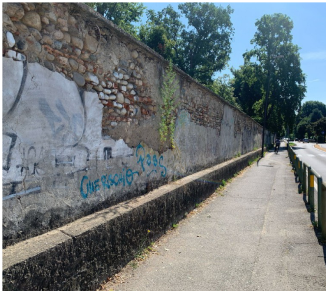
Un tratto del lungo e disastroso muro di cinta che delimita il Giardino Sottocasa sul fronte di via Galbusera
